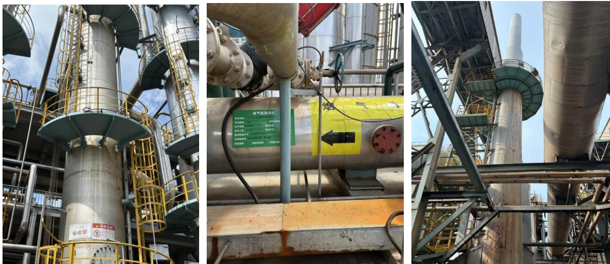
图 4-1 吸收塔（顶部配套水洗段）环保设施、废气监测采样口及排气筒图
